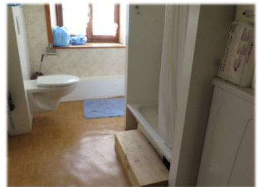
Visite d'un appartement privé dans le Nord Vaudois pour proposer une douche adaptée.
