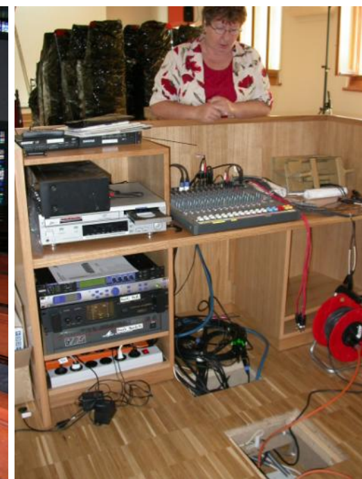
Boucle magnétique installée sous le plancher
